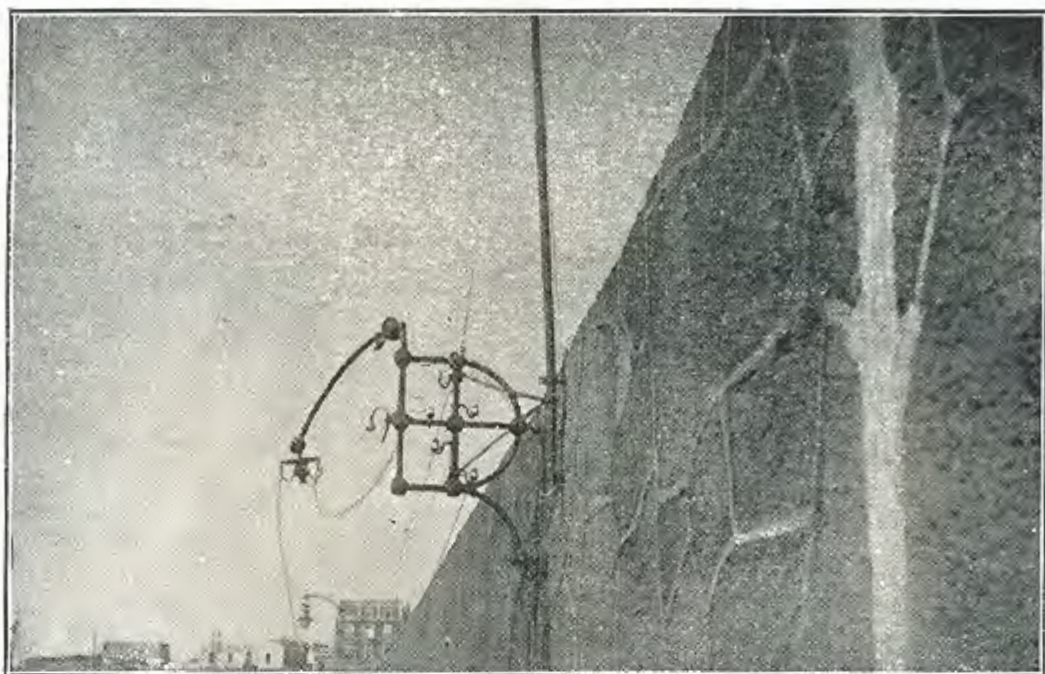
TEMPORAL DE MARZO DE 1925. SOPORTE DE LUZ EN EL ESPALDÓN DEL MUELLE VILLANUEVA
